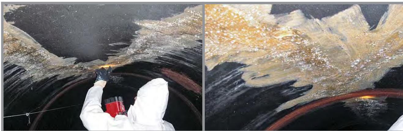
Vasca interrata di contenimento acqua potabile, Gruppo Hera, Rimini
