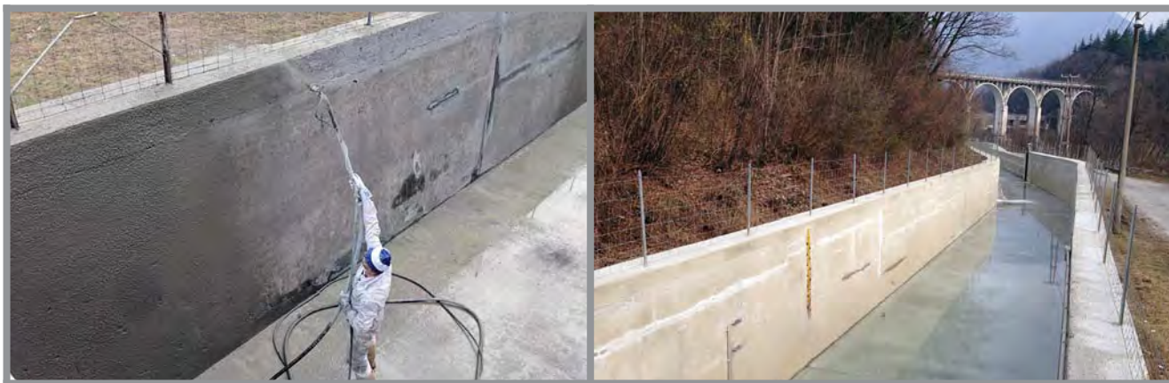
Collettori fognari Via del Nord, Milano
